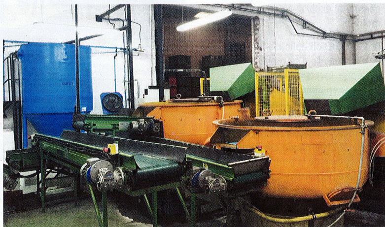
Instalación de vibración con secado y tratamiento de aguas suministrada por Hervel.
